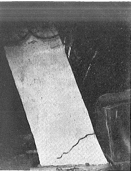
Fig. 52. Revne i trukket skorsten uden stol (ulovligt).
